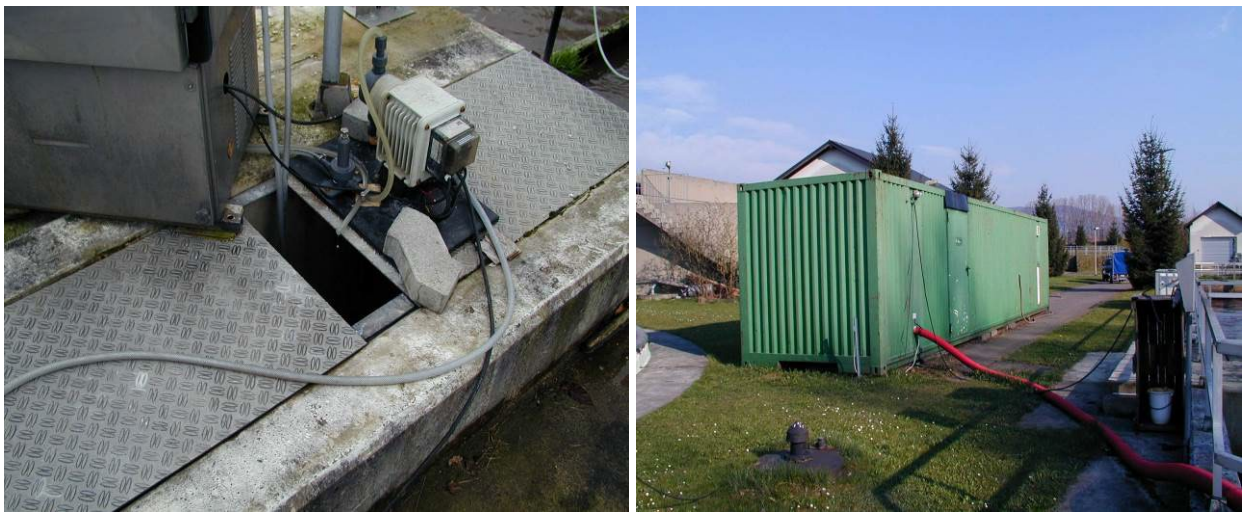
Abb. 6-4: Provisorisch installierte Dosierstelle und Dosierstation
