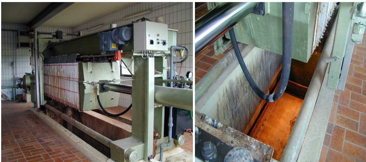
Abb. 6-7: Kammerfilterpresse der Kläranlage Tann und darunter liegender Container
