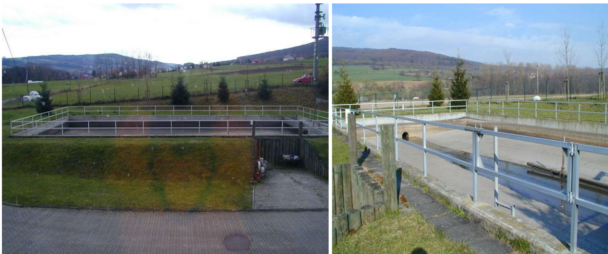
Abb. 6-2: Regenrückhaltebecken der KA Tann/Rhön
